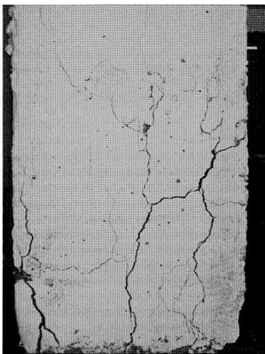
Рис. 1. Характер разрушения железобетонных обойм
